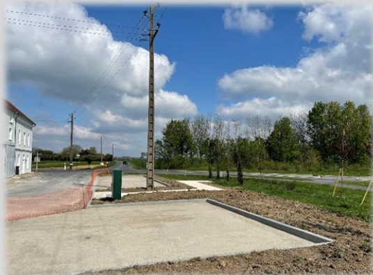
Entre le 4 et 14 avril : épandage de la grave calcaire sur le chemin piétonnier, préparation de l'aire de covoiturage
